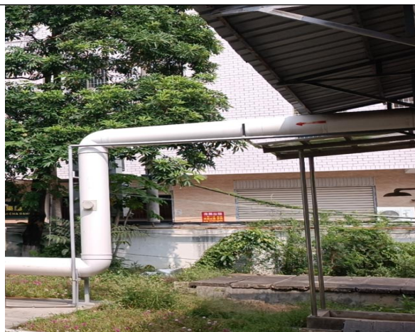
废气收集管道
