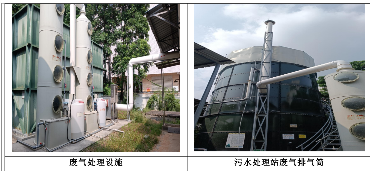
图 3-1 项目废水、废气处理设施现场图
